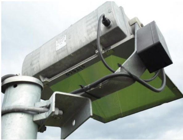
Insgesamt 36 Leuchten von Hersteller Siteco wurden an den Masten angebracht
